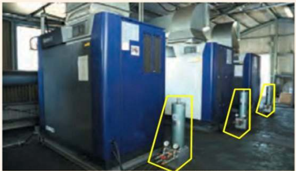
オイルフィルターを外付けしたコンプレッサー
