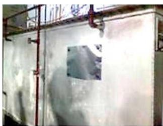
遮熱シート サンプル 貼付中
