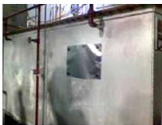
遮熱シート サンプル 貼付中
